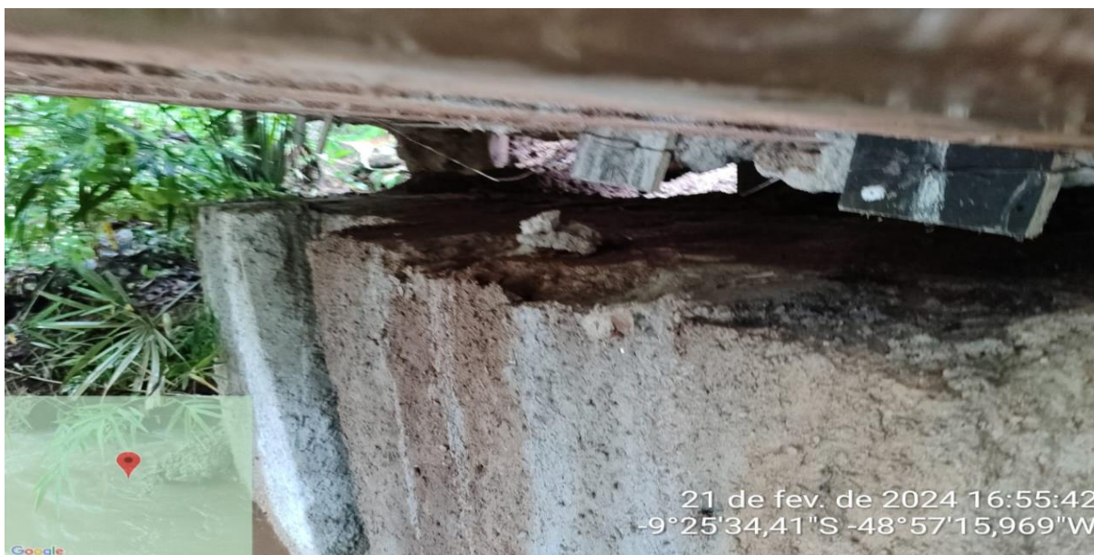
FIGURA 3; PONTE SOBRE O RIO LAJEADO, REGIÃO DO SR. EUPÍDIO. Imagem da cabeceira deslocada por intermédio de um recalque na fundação.
