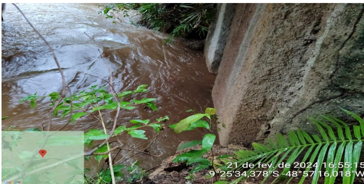
FIGURA 4; PONTE SOBRE O RIO LAJEADO, REGIÃO DO SR. EUPÍDIO. Imagem dos pilares de apoio da cortina com recalque e deslocamento.
